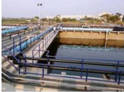
回分槽（処理槽）
